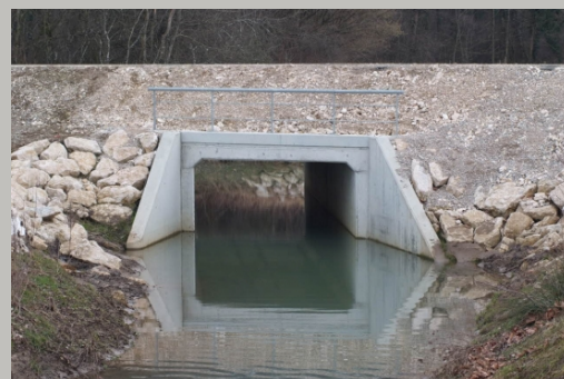
Ouvrage hydraulique - LGV Rhin-Rhône Crédit photo : Eric Laurent
