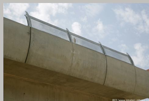
Exemple de protection acoustique sur la LGV Rhin-Rhône
